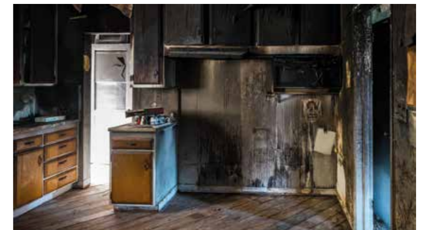
• 3D reality-opnames maken in twee uur een woonhuisschade compleet inzichtelijk
